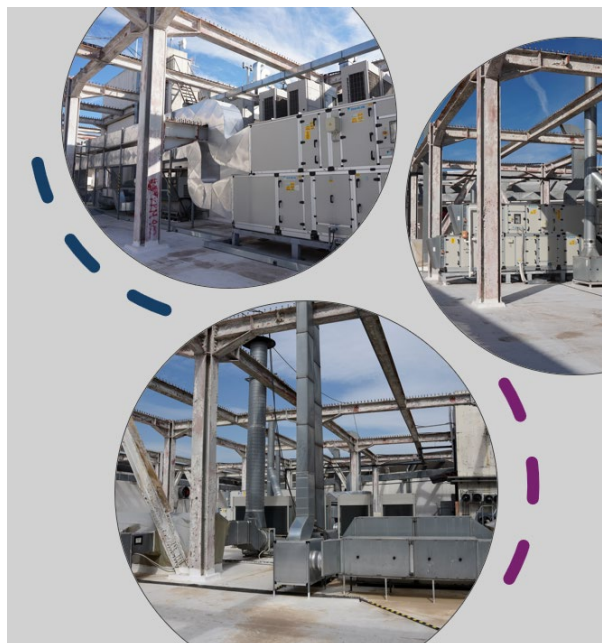
Εικόνα 14: Κλιματιστικές μονάδες του Εμπορικού και Ψυχαγωγικού Κέντρου «The Mall Athens»
