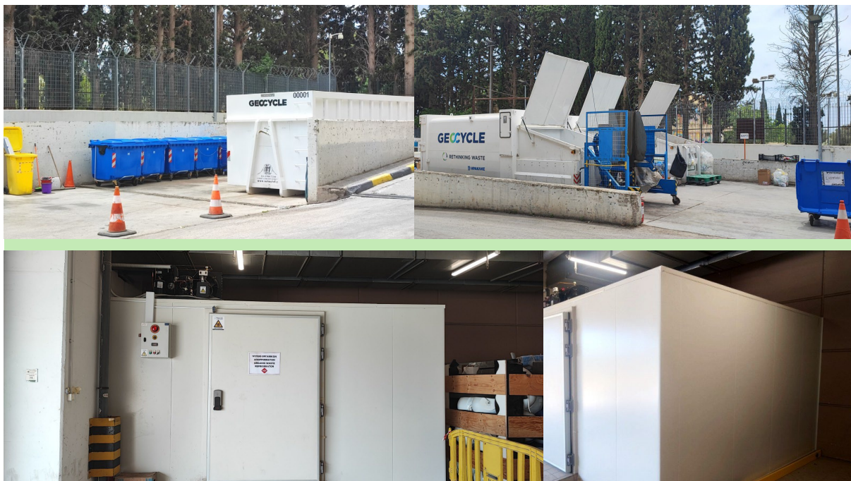
Εικόνα 5: Άποψη του εξωτερικού χώρου συλλογής και ανακύκλωσης απορριμμάτων του Εμπορικού και Ψυχαγωγικού Κέντρου «The Mall Athens» καθώς και του ψυκτικού θαλάμου για οργανικά απόβλητα που βρίσκεται στο ισόγειο εντός του κτιρίου
