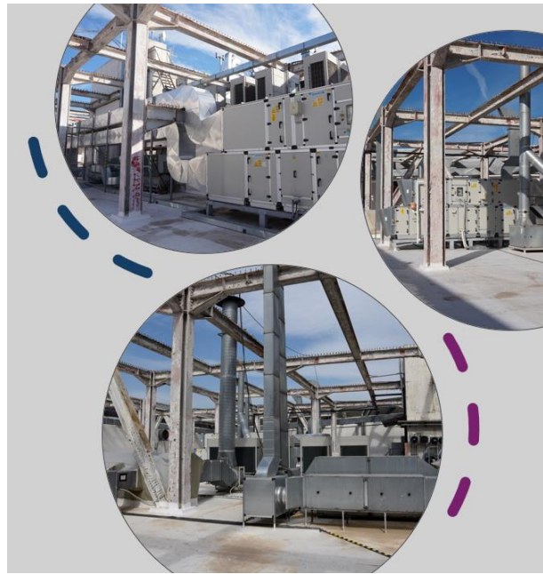
Εικόνα 12: Κλιματιστικές μονάδες του Εμπορικού και Ψυχαγωγικού Κέντρου «The Mall Athens»
