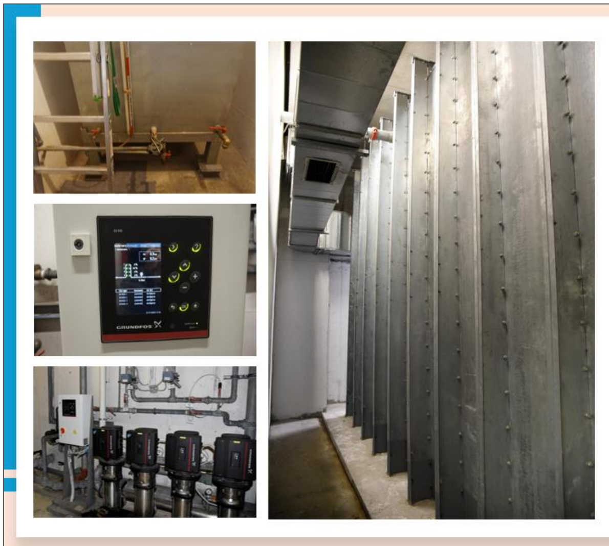
Εικόνα 6: Δεξαμενή ύδρευσης & εγκαταστάσεις διανομής του «The Mall Athens»
